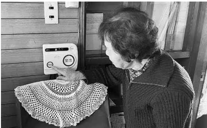
緊急通報システムの設置は生活の安心につながる
